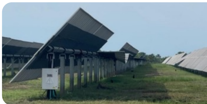
▲ Imagen 2.9 Impacto del viento extremo en la planta solar “El Paso”
