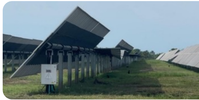
▲ Immagine 2.9 Impatto del vento estremo su impianto solar “El Paso”
