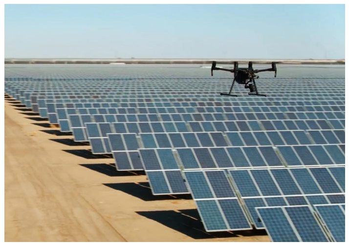
▲ Immagine 3.4 Drone's inspection on PV plant
